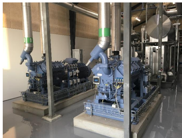
Figur 1: To af i alt syv varmepumpeenheder som udnytter grundvand som varmekilde ved Broager Fjernvarme. [kilde: http://planenergi.dk/arbejdsomraader/fjernvarme/varmepumper/broager/ ]
