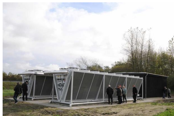
Figur 1: Sig Varmeværks varmepumpeanlæg ved indvielse den 27. oktober 2017 [ https://jv.dk/artikel/sig-er-helt-vilde-i-varmen-og-pumper-prisen-ned ]
