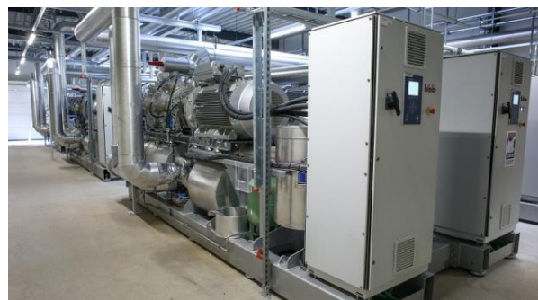
Figur 1: Varmepumpeanlægget i Kalundborg med spildevand som varmekilde. [ https://aea.dk/portfolio-items/varmepumpe-kalundborg-forsyning-2016/ ]
