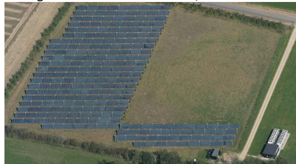
Figur 3: Solvarme- og varmepumpeanlægget i umiddelbar nærhed af hinanden [ https://skraafoto.kortforsyningen.dk/ ]
